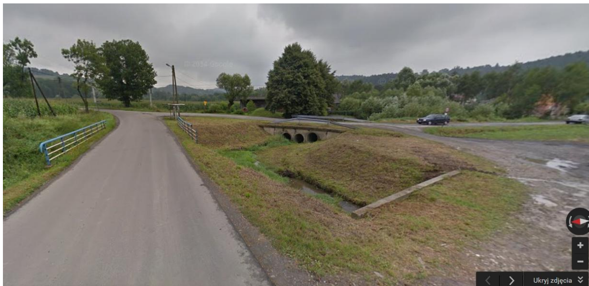
Zdjęcie 2 – Brzeg prawy, km 0,500. Poręba Spytkowska, widok na 2 mostki (przepusty posiadające niewystarczające światło), z prawej ul. Skalna
